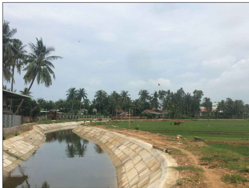
HIỆN TRẠNG MƯƠNG NƯỚC
