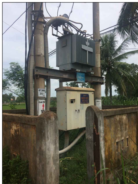
HIỆN TRẠNG TRẠM BIẾN ÁP
