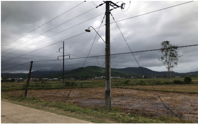
Hình Tuyến điện 22 kV trong khu vực
